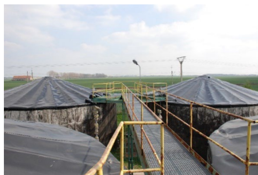
Fot. 2. Przykrycie zbiorników na gnojowicę (J. Walczak).
